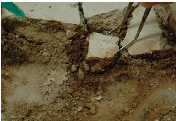
Fig. 2. Eliminación del engasado, realizado in situ como refuerzo, separando la trama con inyecciones de disolventes de alta volatilidad.
