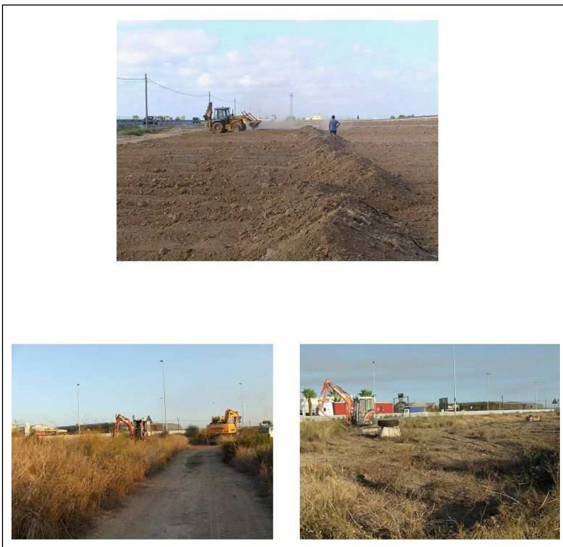
Desbroce y apertura de pista entre los cortes V-208 / V-210 y V-216 / V-218.
