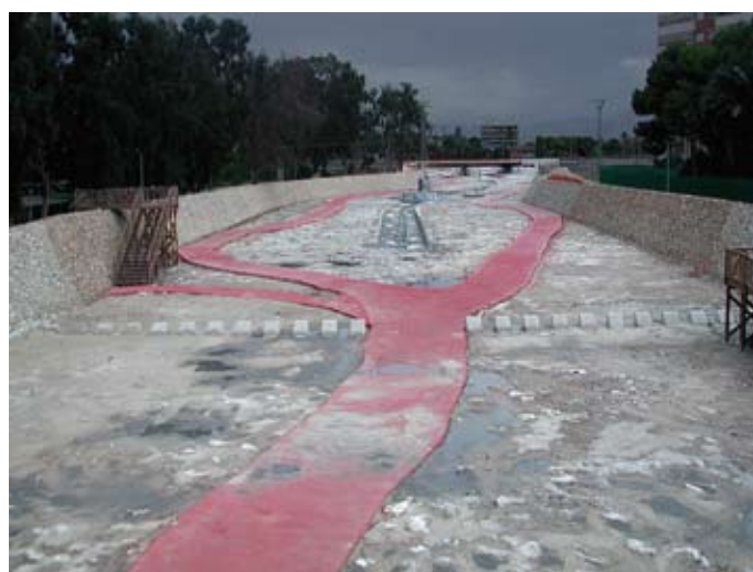
Figura 11. La obra hidráulica del encauzamiento una vez acabada en el año 2003. Tramo final entre el trenet y la Playa de la Albufereta.
