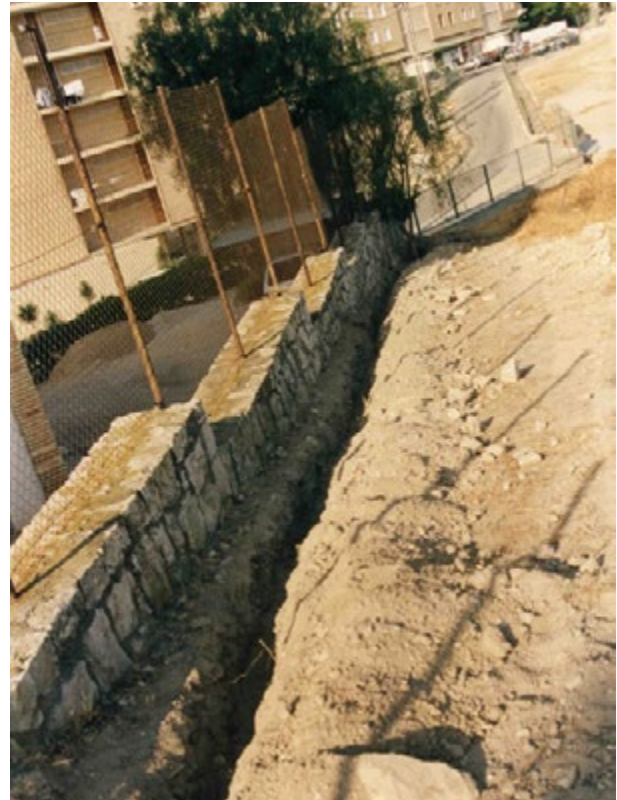
Fig. V.150: Zanjas para la plantación de barrera vegetal junto a la valla del yacimiento. 1993. ATM
