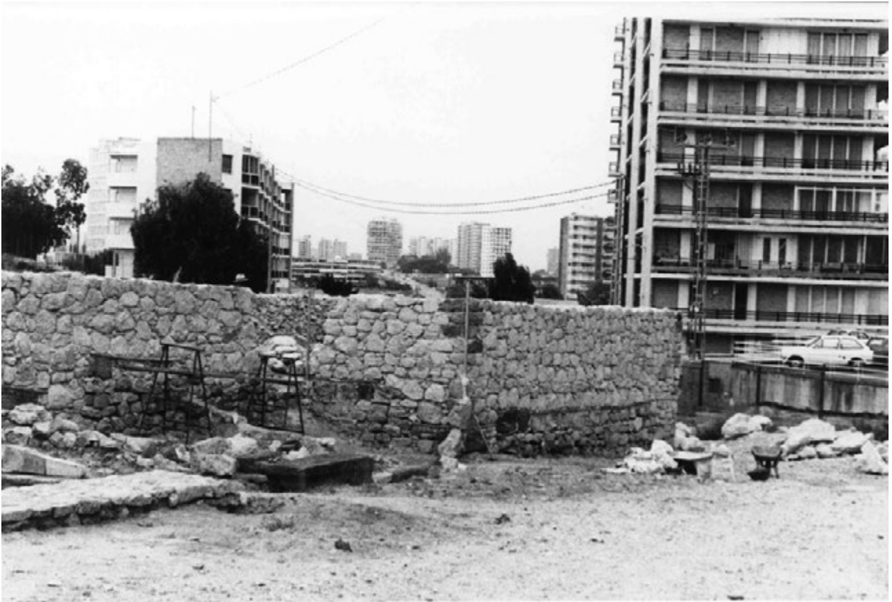
Fig. V.112: Trabajos de restauración de la torre II. 1980. Obsérvese la línea de ladrillos para separar la obra nueva de la original. ATM.
