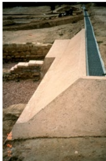
Fig. V.162: Talud de protección y drenaje en su borde superior que recoge el agua de escorrentía y la evacúa al exterior del yacimiento. ATM.
