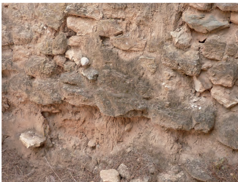
Excavación por debajo de la cota de cimentación. Descalce de fábrica
