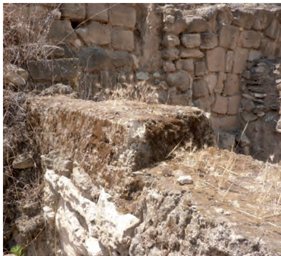
Alteración superficial de fábrica. Presencia de organismos vivos (costras)
