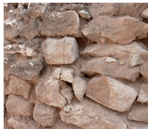
Fracturas por exceso de carga
