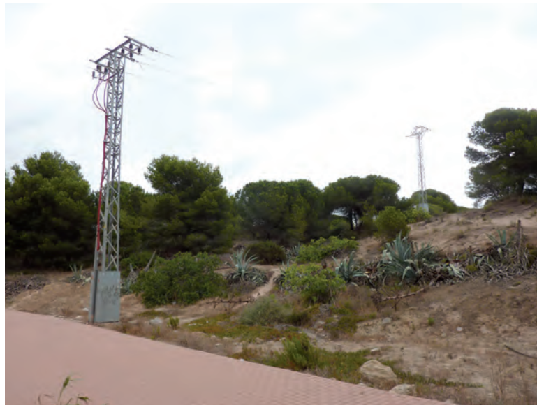
Línea de media tensión
