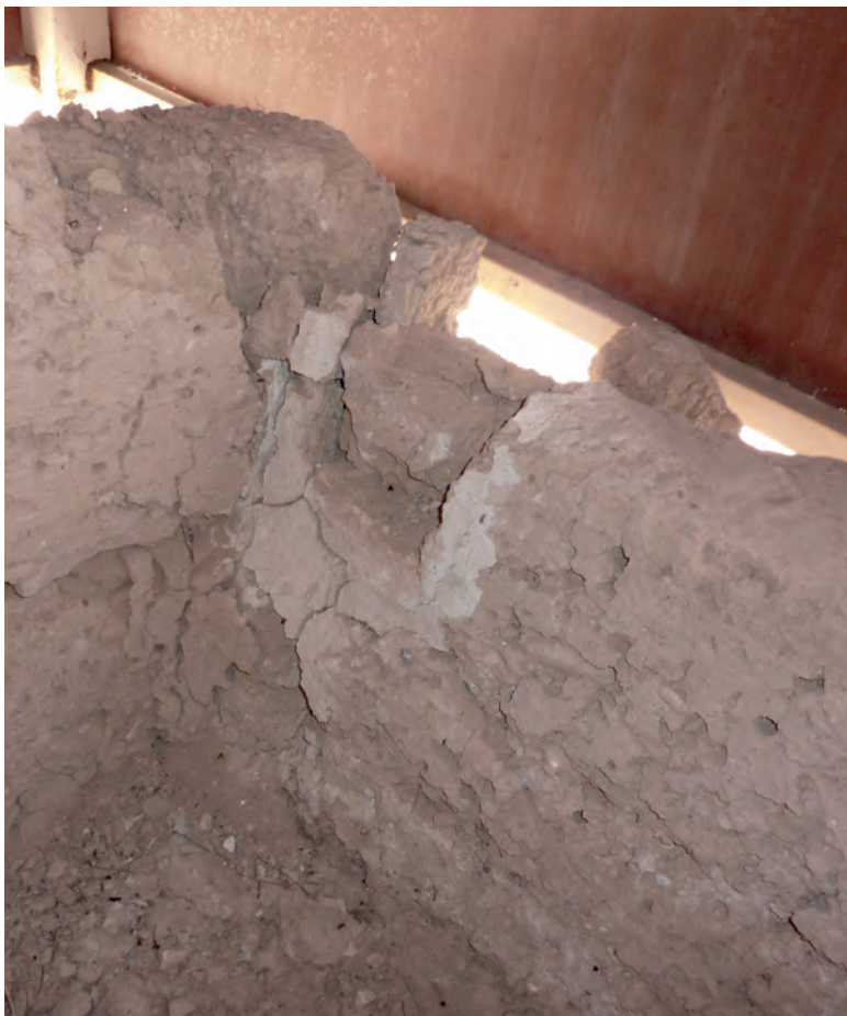
Degradación estructuras de adobe cubiertas con casetón
