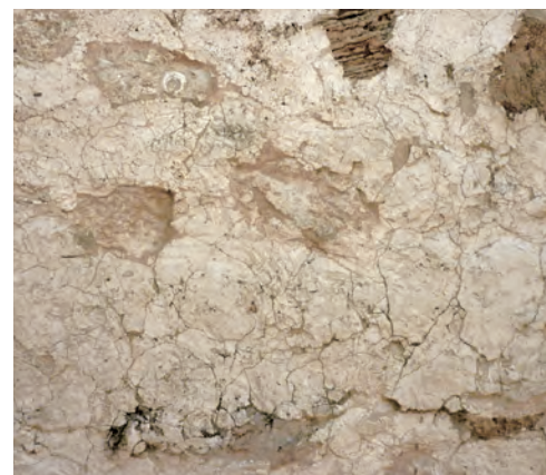
Fisuras en un revestimiento por cambios de temperatura y humedad
