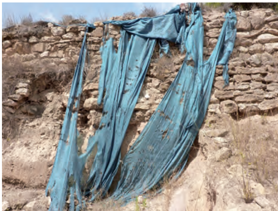
Protecciones insuficientes, sin la adopción de medidas adecuadas
