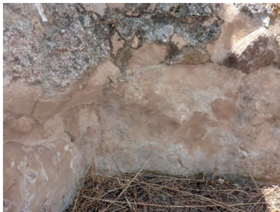
Degradación de revestimiento por eflorescencias y criptoflorescencias
