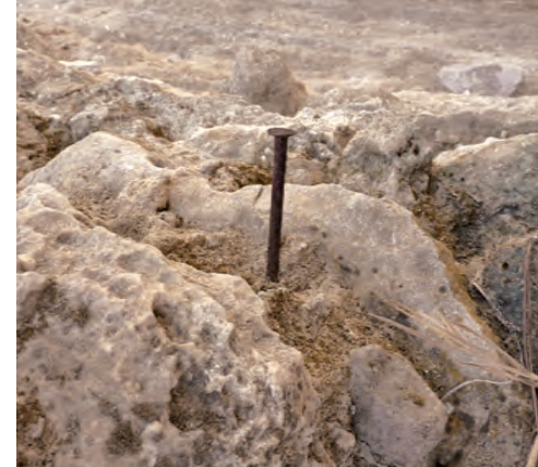
Alteración por intrusión de materiales auxiliares olvidados
