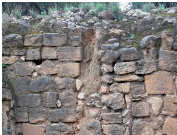
Cambio cromático en piezas de una fábrica por carbonatación-oxidación
