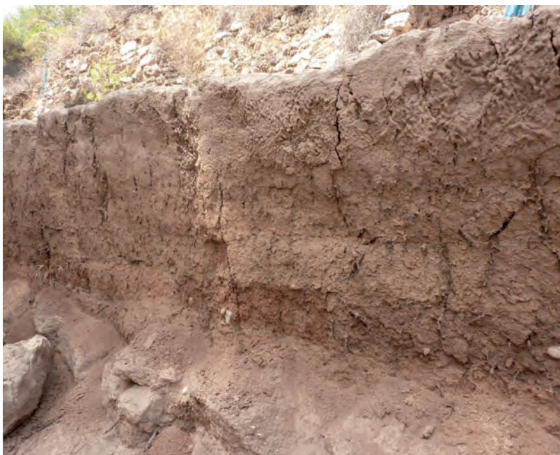
Degradación de estructura de adobe por erosión atmosférica
