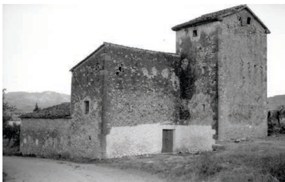
Figura 10. La Torreta. Cocentaina (edifici enderrocant), lloc on se situava un convent mercedari destruït durant la guerra de la Unió.
