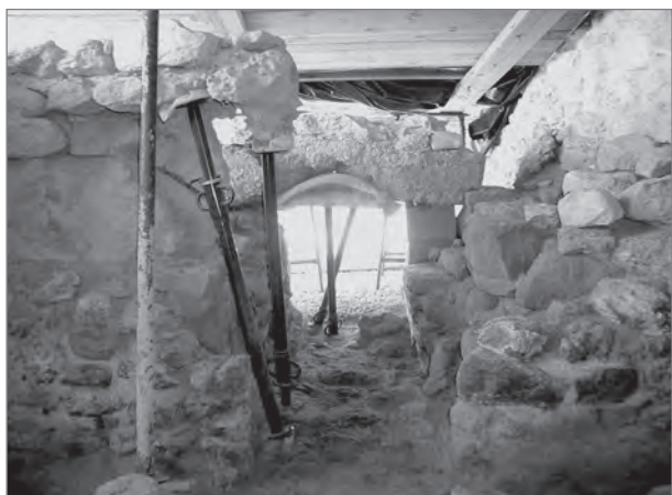
Figura 242. Detalle del arco del caldarium del que sólo se conserva el salmer y los restos de las dos dovelas que se encuentran en primer plano apuntaladas.
