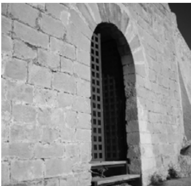
Figura 1.8. Estado de los paramentos y bóveda del Palau en el 86.
