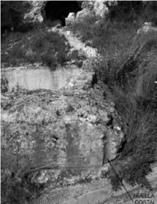
Figura 3.96. Detalle de la fábrica de tapial con la huella de un costal que servía para el proceso de encofrado del muro del aljibe.
