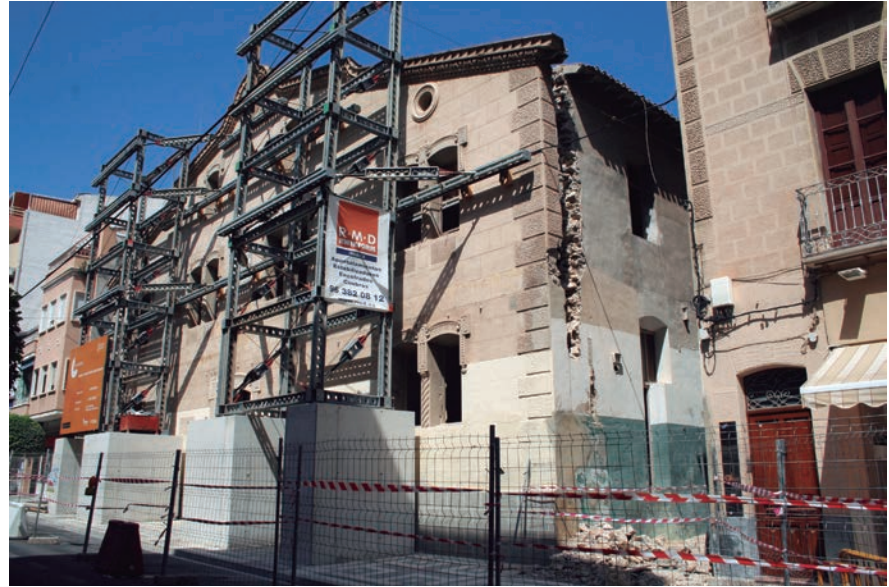
Làmina VIII. Treballs d'apuntalament de la façana de l'antic col·legi Dr. Esquerdo, per a la seua restauració i conservació davant del nou edifici del Museu.
