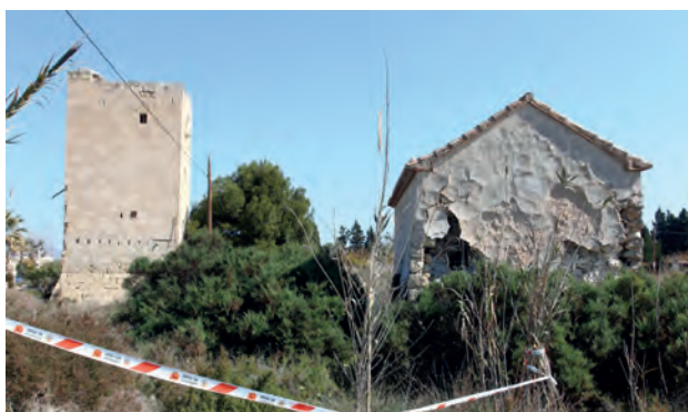
Figura 8.32: El lamentable estado de abandono de la ermita y torre Ciprés en la actualidad. Si no se detiene a tiempo, la defensa acabará por caer o ser destruida por la creciente expoliación de la zona.
