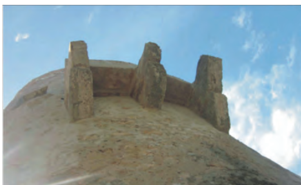
Figura 6.107: Detalle del tiro de la ladronera, sellado posteriormente, del que aún se conservan las mensulas. Foto: María Jesús Sánchez Mora.
