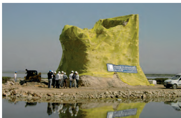
Figura 8.20: Andamiaje y cubierta de protección de la Torre de Tamarit mientras se realizaba su restauración. Foto: Arquealia.
