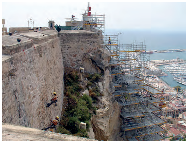
Figura 8.17: Trabajos previos de estudio, catalogación y clasificación de todas las lesiones existentes en el Macho del Castell dirigidos por el arquitecto Marius Bevià García y realizados por la empresa Equipos Técnicos de Rehabilitación durante el binomio 2007-2008. Archivo Marius Bevià.
