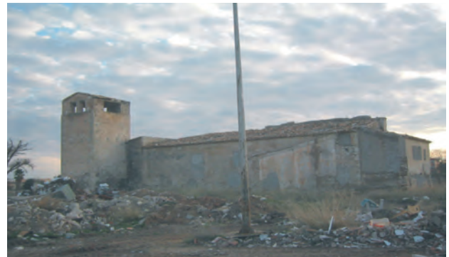
Figura 8.24: La Torre Ansaldo y el erial de abandono, basura y ruinas que se encuentra actualmente a su alrededor. Foto: Marius Bevià.
