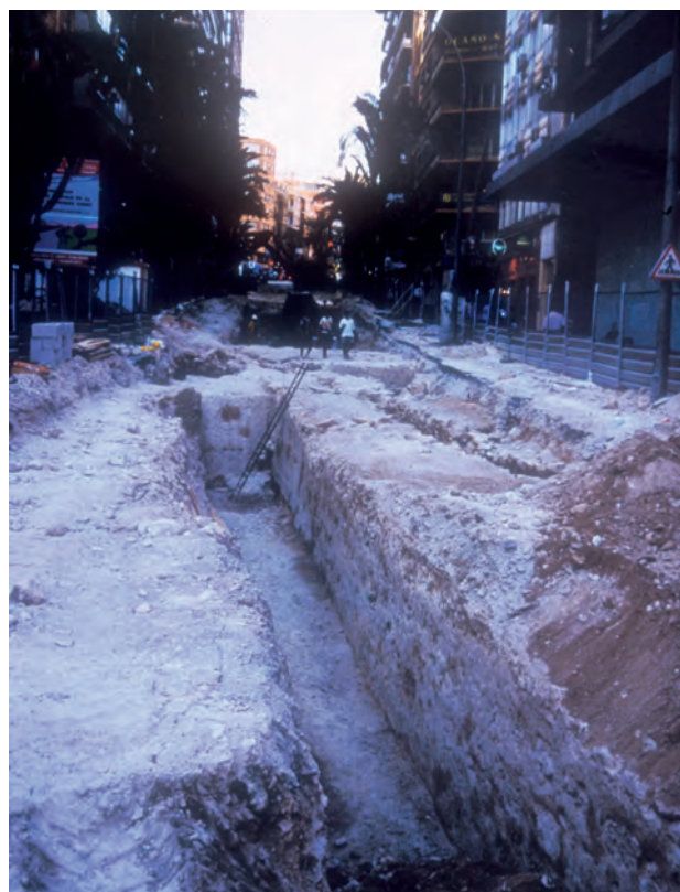
Figura 7.17: Lienzo y foso de la muralla pre-abaluartada levantada por el Duque de Calabria durante la primera mitad del siglo XVI y descubierta hace unos años en la Rambla de la ciudad de Alicante.
