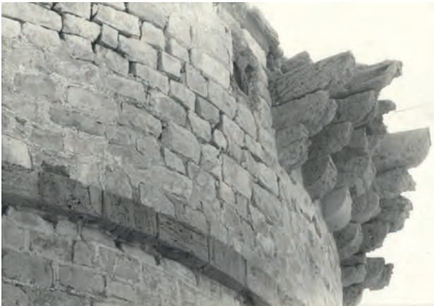
Figura 6.49: Detalle de las mensulas del matacán y su interrupción en el paramento del remate. Foto: Marius Bevià.
