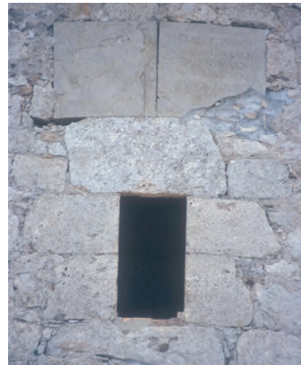
Figura 6.33: Detalle del acceso en altura y de la inscripción de reforma instalada por Vespasiano Gonzaga en su período de Virrey del Reino de Valencia. Año 1577.
