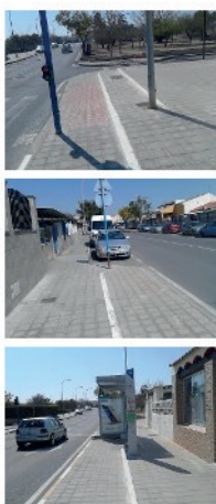
ACERA EN TRES NIVELES CON RAMPAS SIN PAVIMENTO TÁCTIL DIRECCIONAL PARADA DE AUTOBÚS CON MARQUESINA SIN PAVIMENTO TÁCTIL Y SEÑAL VERTICAL QUE INTERRUMPE EL ITINERARIO PEATONAL
