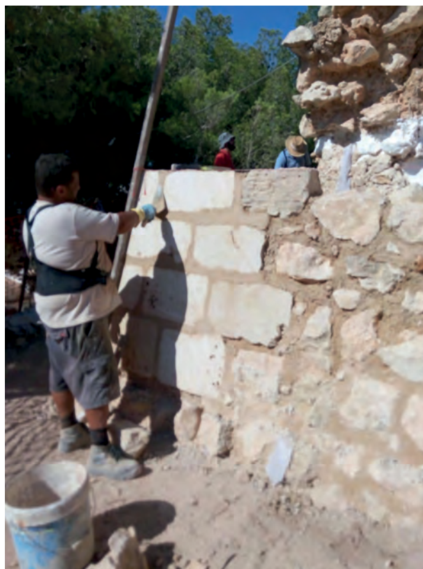
Figura 33: Trabajos de consolidación preventiva en la T3 de la muralla de Ifach durante la campaña de 2015. Área de Arquitectura. Diputación de Alicante. Archivo Gráfico MARQ.
