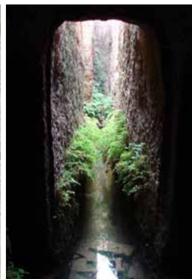
Fig. 5.73. Erosión por escorrentías de agua de lluvia
