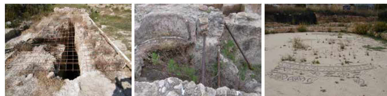
Fig. 5.98. Protecciones provisionales de caídas a distinto nivel
