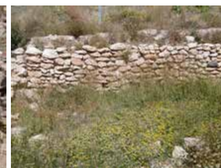
Fig. 5.81. Pérdida de argamasas de agarre y rejuntado en muros
