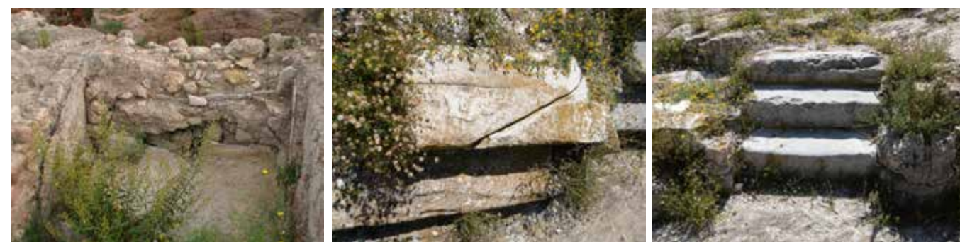
Fig. 5.86. Desprendimiento del soporte, derrumbe y descalce o pérdida de apoyo
