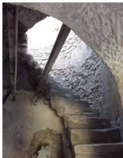
Fig. 5.16. Plataforma con desprendimiento de mampostería
