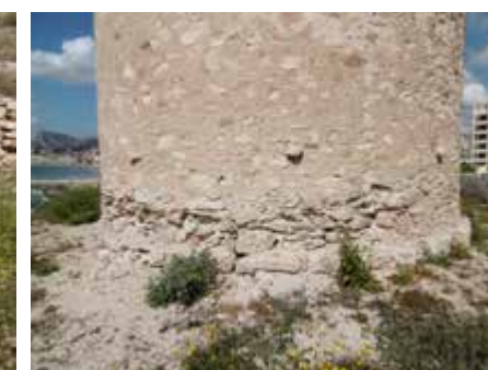
Fig. 5.82. Pérdida de argamasas de agarre y rejuntado en fábricas del Molí del Morelló
