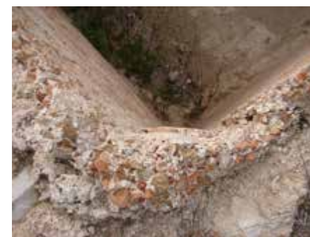
Fig. 5.77. Desintegración de los bordes de revestimientos de opus signinum
