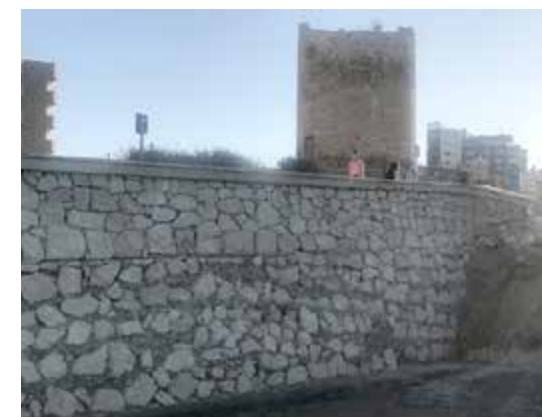
Fig. 2.152. Diferencias en la ejecución de la mampostería
