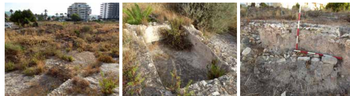
Fig. 5.21., 5.22. y 5.23. Imágenes que demuestran el grave estado de deterioro de la Vivienda 2
