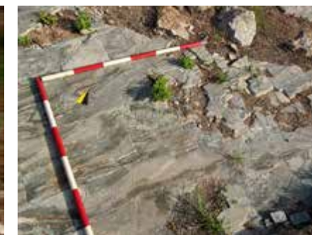
Fig. 5.31. Alteraciones en el pavimento marmóreo, 2017
