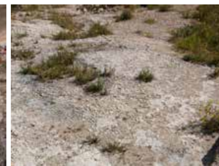
Fig. 5.78. Desintegración y carbonatación de opus caementicium en formación de pavimentos
