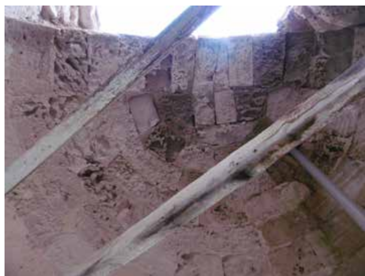
Fig. 5.75. Formación alveolada extrema en sillares del Molí del Morelló, con alarmante pérdida de sección resistente
