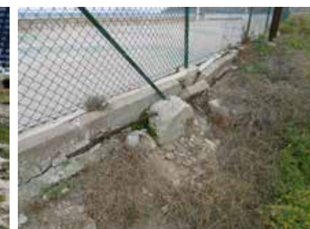
Fig. 5.68. Vallado arruinado en el lindero noroeste, a reconstruir
