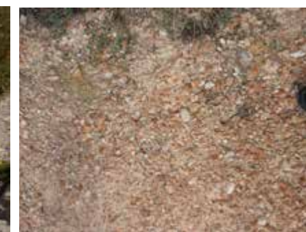
Fig. 5.79. Disgregación y desprendimiento de componentes de pavimentos de opus signinum . También por la fricción mecánica de pisadas de visitantes
