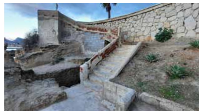
Fig. 5.12. y 5.13. Estado que presenta la escalera de acceso al Conjunto Arqueológico de la piscifactoría
