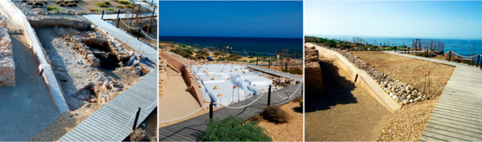
Figura 4. Trabajos de recuperación y puesta en valor de la segunda calle longitudinal de La Illeta y del conjunto de edificios que constituyen la fachada S0.
