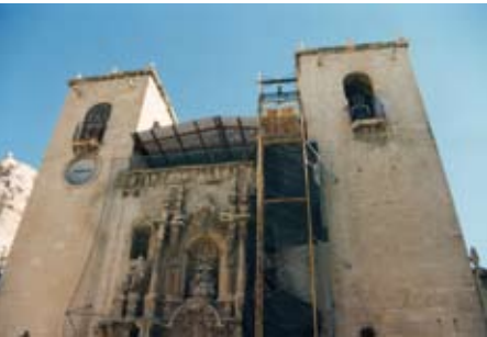
Figura 1. Fachada de la Iglesia de Santa María de Alicante en el año 1997. En la parte superior, la cubierta artificial que se dispuso para poder realizar la excavación arqueológica en el techo de la iglesia.
