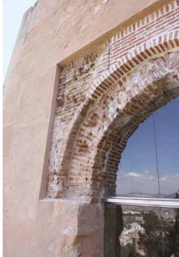
Figura 26. Detalle del arco y alfiz de ladrillo consolidados en la Torre de Sant Jordi.
