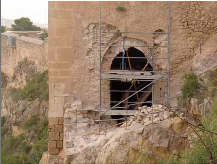
Figura 12. Alzado exterior del vano gótico mudéjar de la Torre de Sant Jordi durante la fase de excavación parietal con perspectiva del lienzo de muralla Este.
