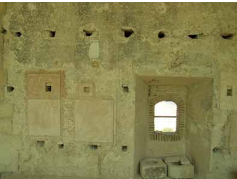
Figura 17. Paramento interior Este de la planta primera de la Torre de Santa Caterina durante la fase de trabajo para la elección de la puesta en valor del acabado de los detalles constructivos del lienzo de tapial.
