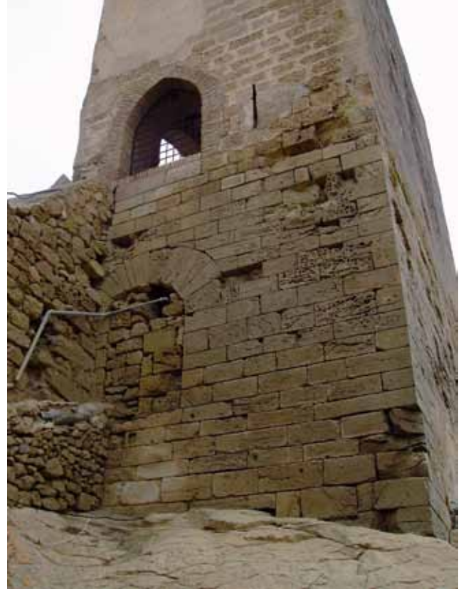
Figura 13. Perspectiva exterior de las plantas baja y primera del alzado meridional de la Torre de Santa Caterina antes de comenzar las obras de restauración.
